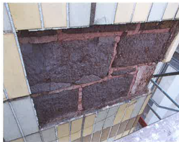
Abb. 3: Bauteilöffnung nach Feststellung der Schäden, 2016 (Foto: Sabine Aumann)
